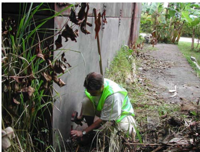
T3 / N°153 : échantillonnage de fibrociment dans l'ancienne canalisation de récupération des eaux de toiture du blockhaus destiné à protéger les militaires à Taku (Mangareva). L'épaisseur des murs est de 60 centimètres. CRIIRAD, le 8 octobre 2005.
