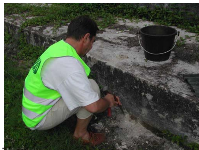
T4 / N°15 : échantillonnage de ciment poreux de l'ancien caniveau de récupération des eaux de lavage de la façade ouest du toit du hangar destiné à protéger la population à Rikitea (Mangareva). CRIIRAD, le 8 octobre 2005.
