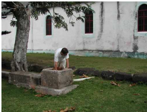
T2 / N°68 : Contrôles radiométriques dans un regard du système de canalisation des eaux de toiture de la cathédrale de Rikitea. CRIIRAD, le 5 octobre 2005.
